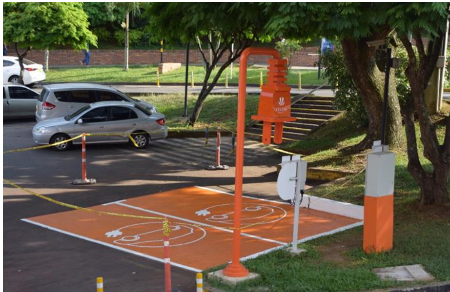
Estaciones de recarga para vehículos eléctricos (instaladas en el año 2018)
